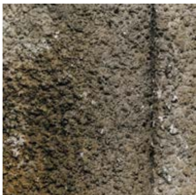
Paredes sucias, enmohecidas o húmedas
